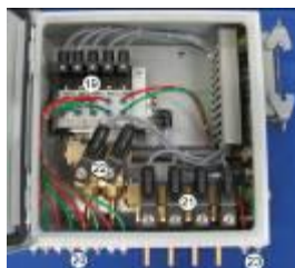
Ventileinheit: 4 Sprühkreise und 2 Blaskreise
